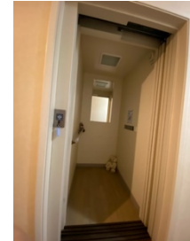
写真8 ホームエレベーター
