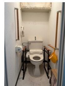
写真2 トイレ手すり
